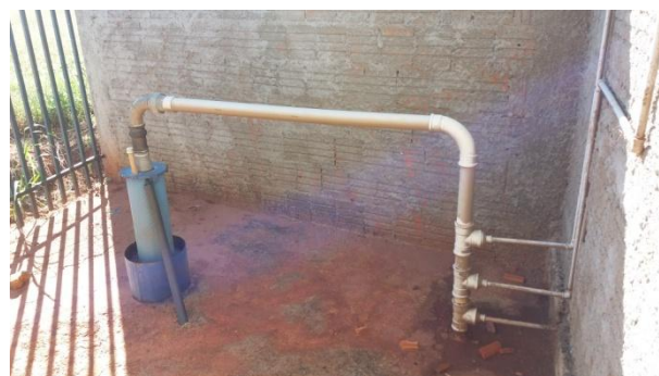
Foto 6.4 – Poço Profundo – PP 04
