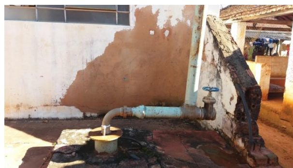
Foto 6.2 – Poço Profundo – PP 02
