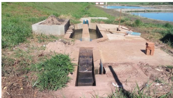
Foto 6.15 – Entrada de ETE – Gradeamento e caixa de areia
