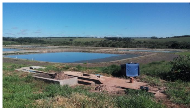
Foto 6.16 – Caixa de areia
