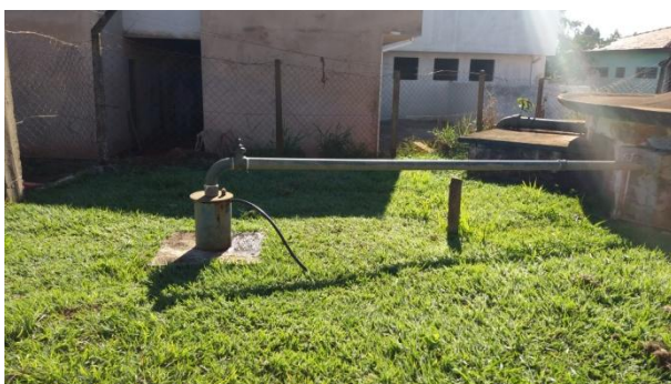
Foto 6.3 – Poço Profundo – PP 03
