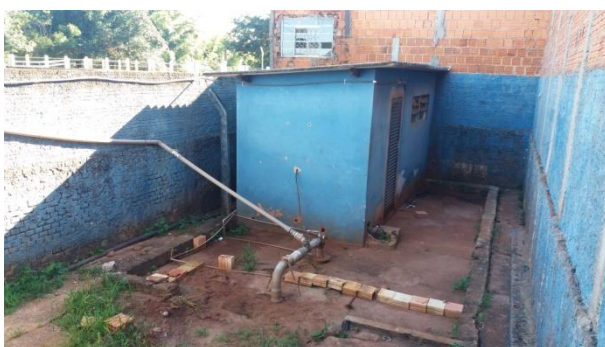
Foto 6.1 – Poço Profundo – PP 01
